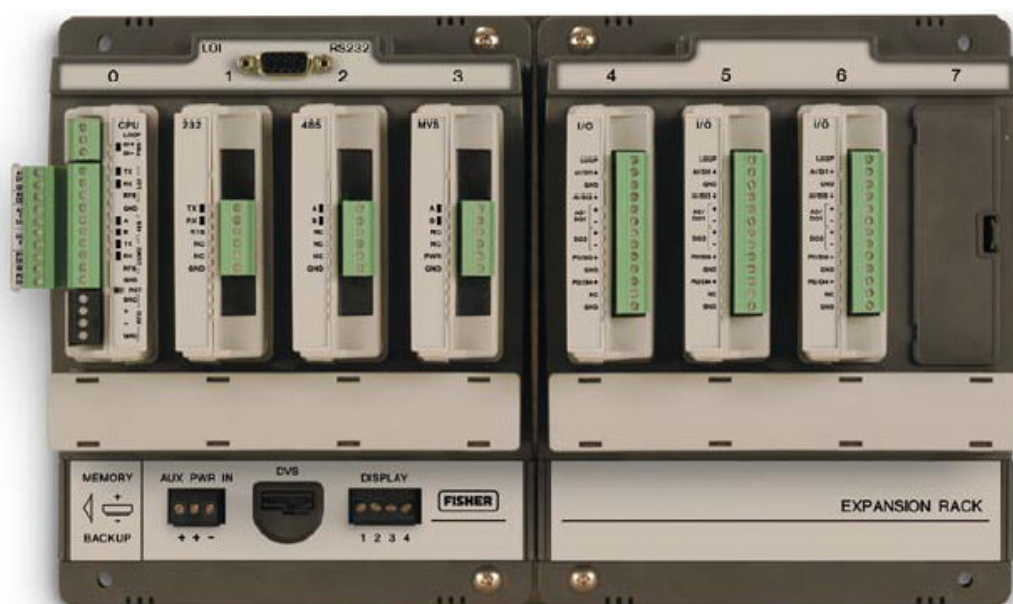
Floboss 107 com rack de expansão instalado
