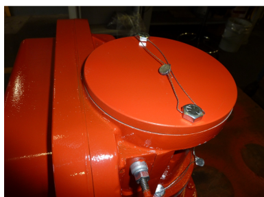
Imagem do ponto PS5 com a tampa do acoplador (sem LNC)
